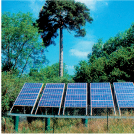
Panneaux solaires à Bonfond (Haute-Loire)
